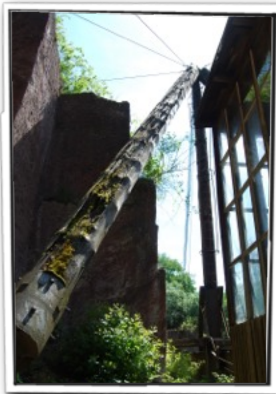
Der Zahn der Zeit nagt am Kran-Gebälk...
