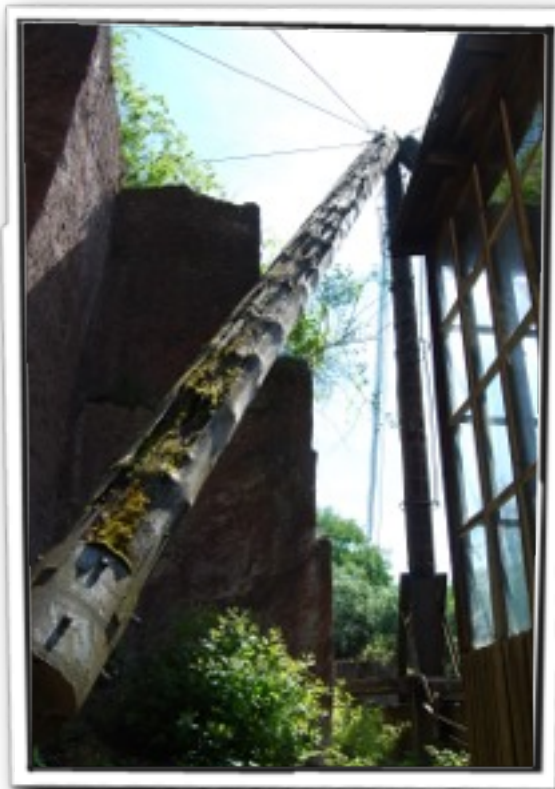
Der Zahn der Zeit nagt am Kran-Gebälk...
